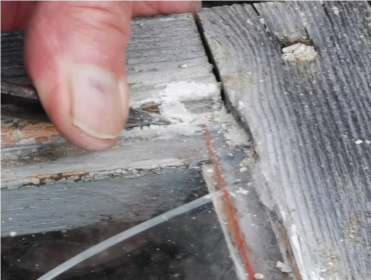
3. Liian suuren lasin aiheuttama halkeama
